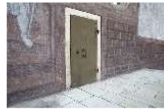
ND.I, Schlosskapelle, zugemauertes Türchen, DI003519, BSV
